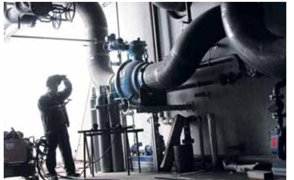
Heißes Wasser aus der Tiefe: Noch ist die Bohrung im Neubaugebiet Freiham nicht erfolgt. Das Geothermie-Heizkraftwerk steht aber schon. Foto: Robert Haas
